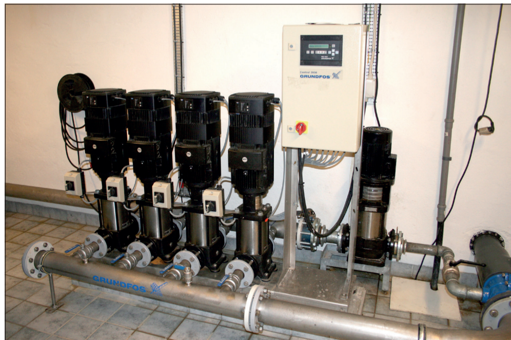
En detalje fra teknikken i vandværksbygningen i Møllegade.
