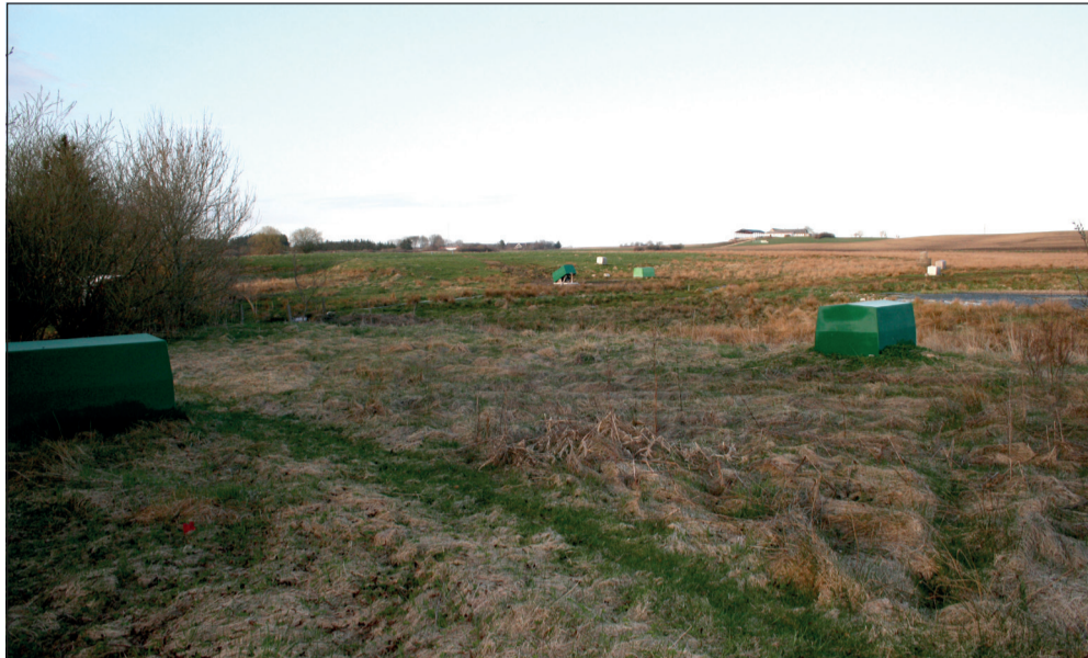
Vandindvindingspladsen ved Østervrå i 2011. De grønne hætter beskytter borer, pumper og trykforøgere.
